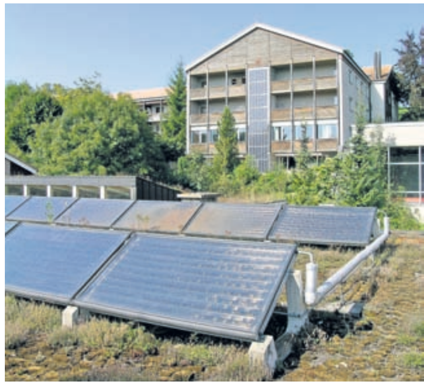
Solaranlage in die Jahre gekommen und arbeitet immer noch einwandfrei.
